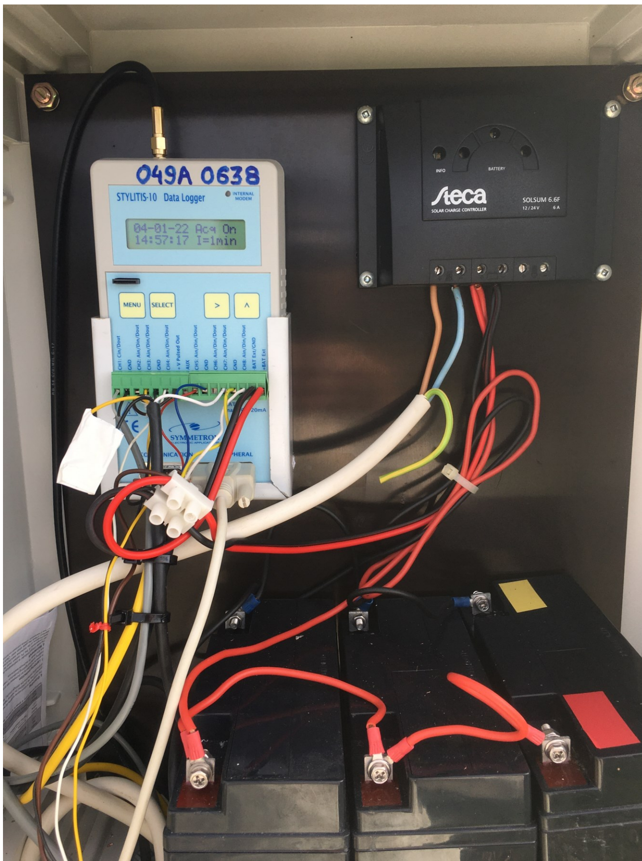
Εικόνα 1.2-6: Ο νέος ψηφιακός καταγραφέας εγκατεστημένος εν λειτουργία στον σταθμό KTL-1 στις 4/1/2022.
