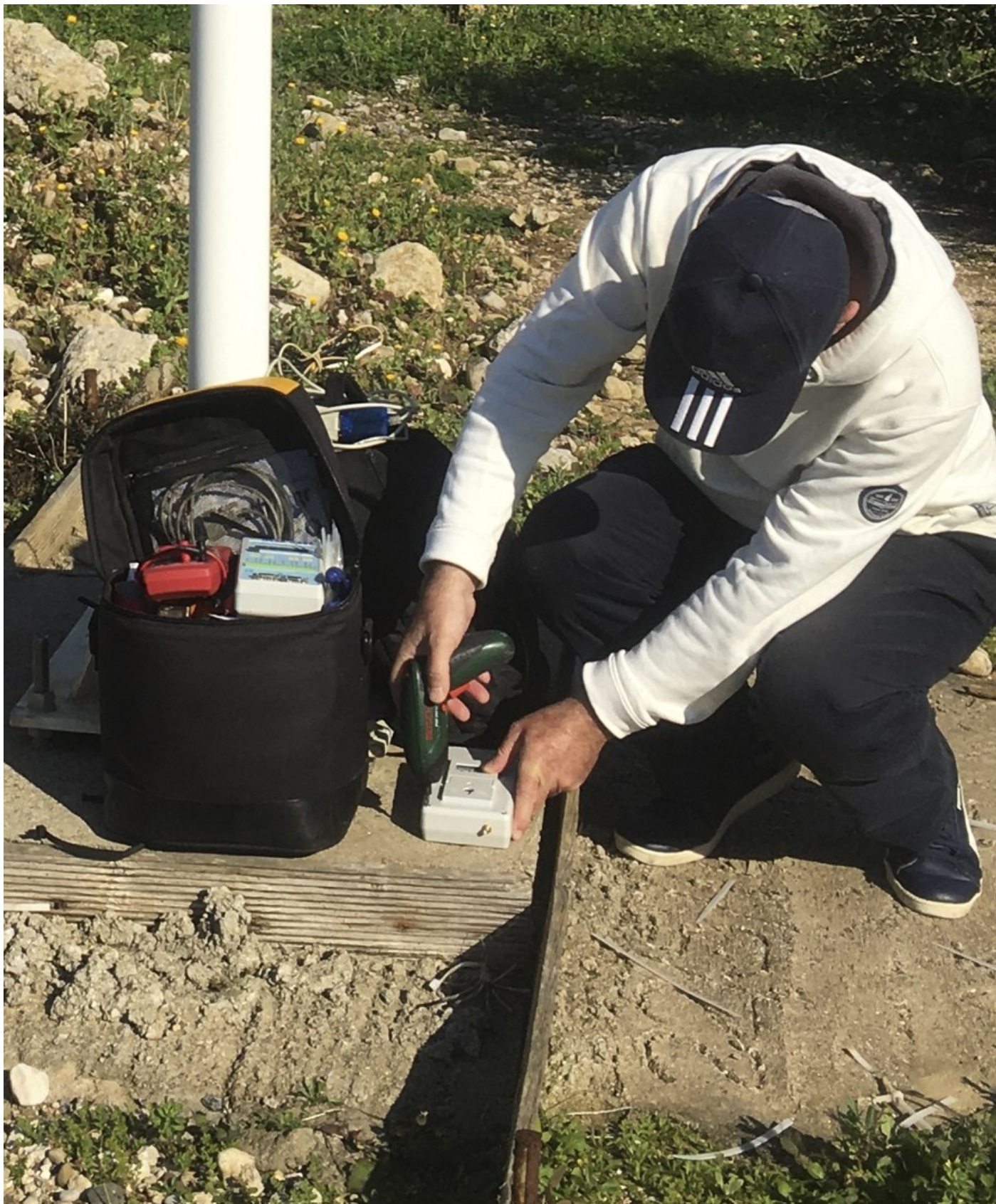
Εικόνα 1.2-3: Απο τις τεχνικές εργασίες στον σταθμό KTL-1 στις 4/1/2022 (εργασίες στοκύκλωμα του ψηφιακού καταγραφέα).
